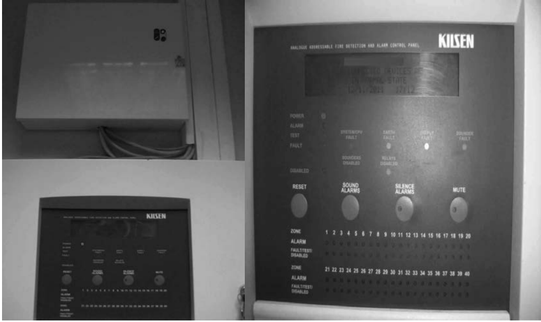
Resim 2.10: Yangın Alarm Panelleri
